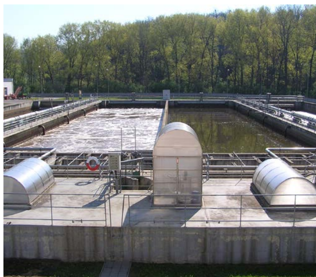
Foto 8. Čistírna odpadních vod (aktivační nádrž; vlevo provzdušňovaná část, vpravo neprovzdušňovaná část)
