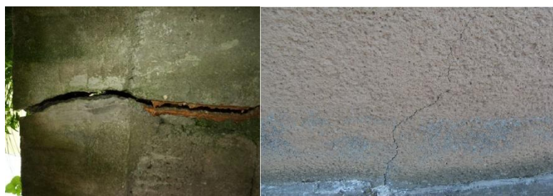
Obr. 9 Porušenie obvodového muriva rodinného domu
