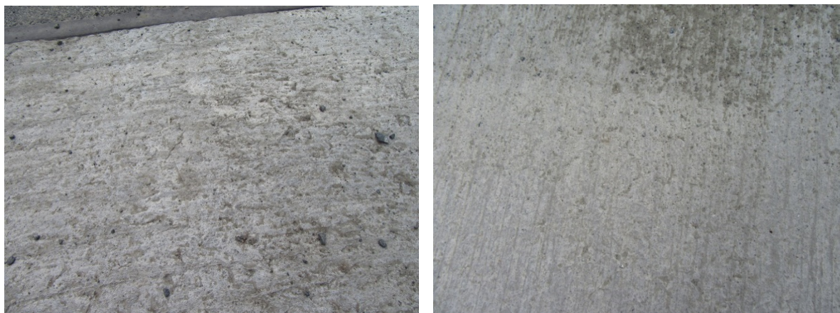
Obrázek 83 Povrch přímo pojižděné mostovky z vláknobetonu po třech letech provozu (vlevo bod B01, vpravo bod B04).
