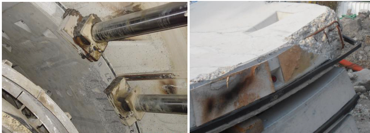
Obrázek 64 Vlevo odlamování hran železobetonových segmentů při zatížení lisy razícího štítu [135]. Vpravo porušení krycích vrstev segmentu na styčných spárách [136].
