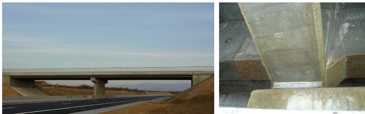
Obrázek 40 Dálniční nadjezd u Bourg-lès-Valence. Vpravo povrchová koroze drátků u podpor [107].
