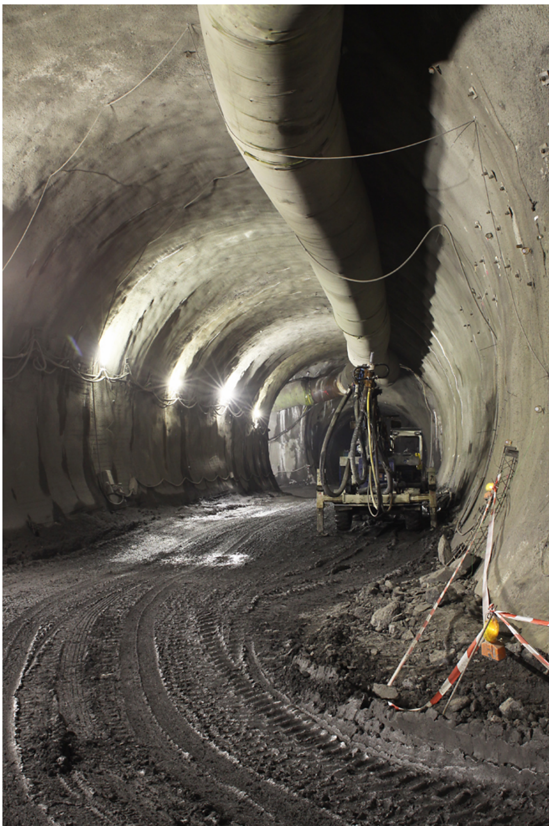
Obr. 2 – Trhliny a dodatečné kotvení na přechodu TGC 4 - strojovna
