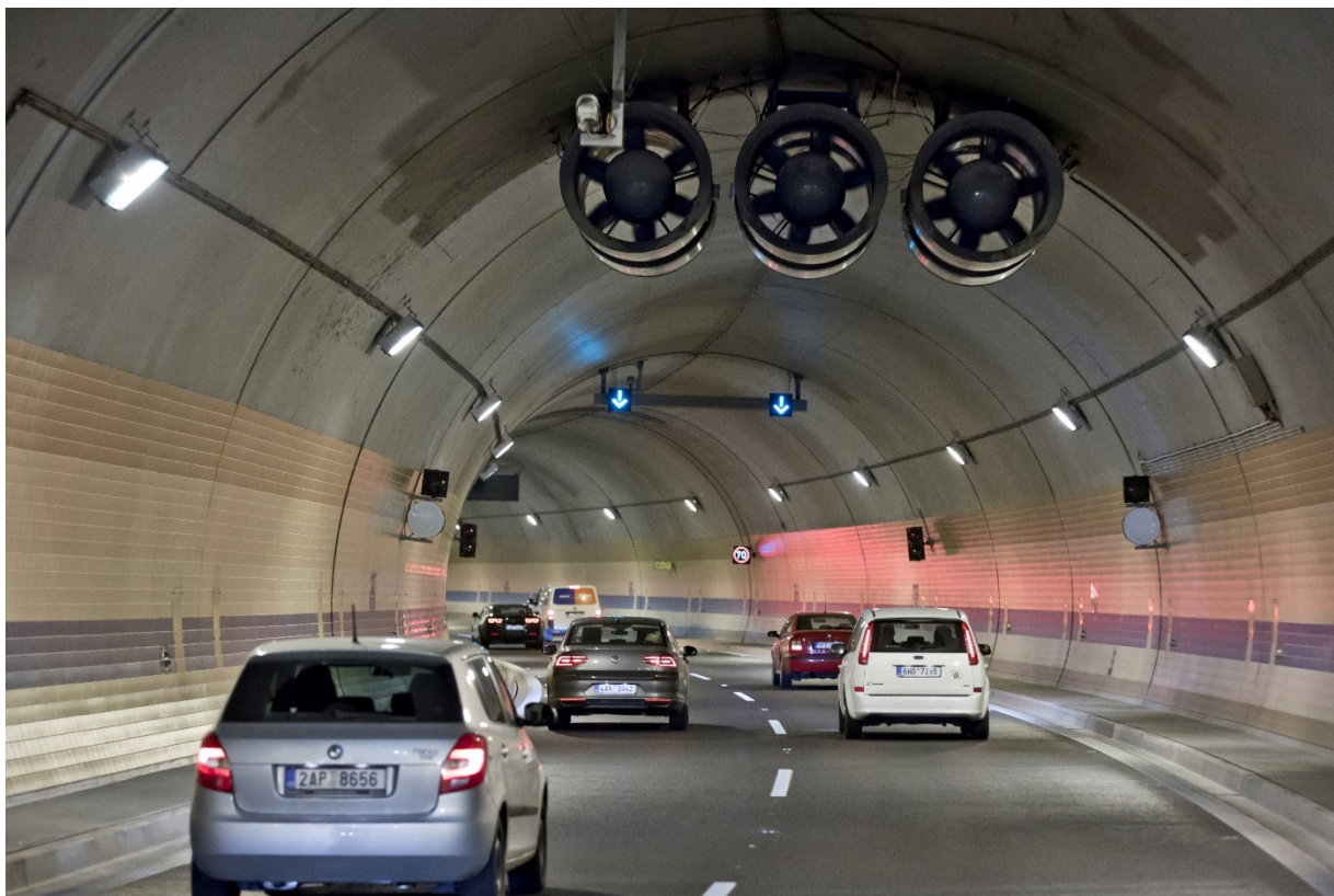
Obr. 7 – Technologické vybavení tunelu
