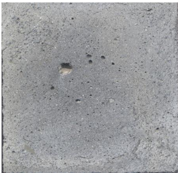
Obr. 56 Ořezaná fotografie řezné plochy betonu [86].
