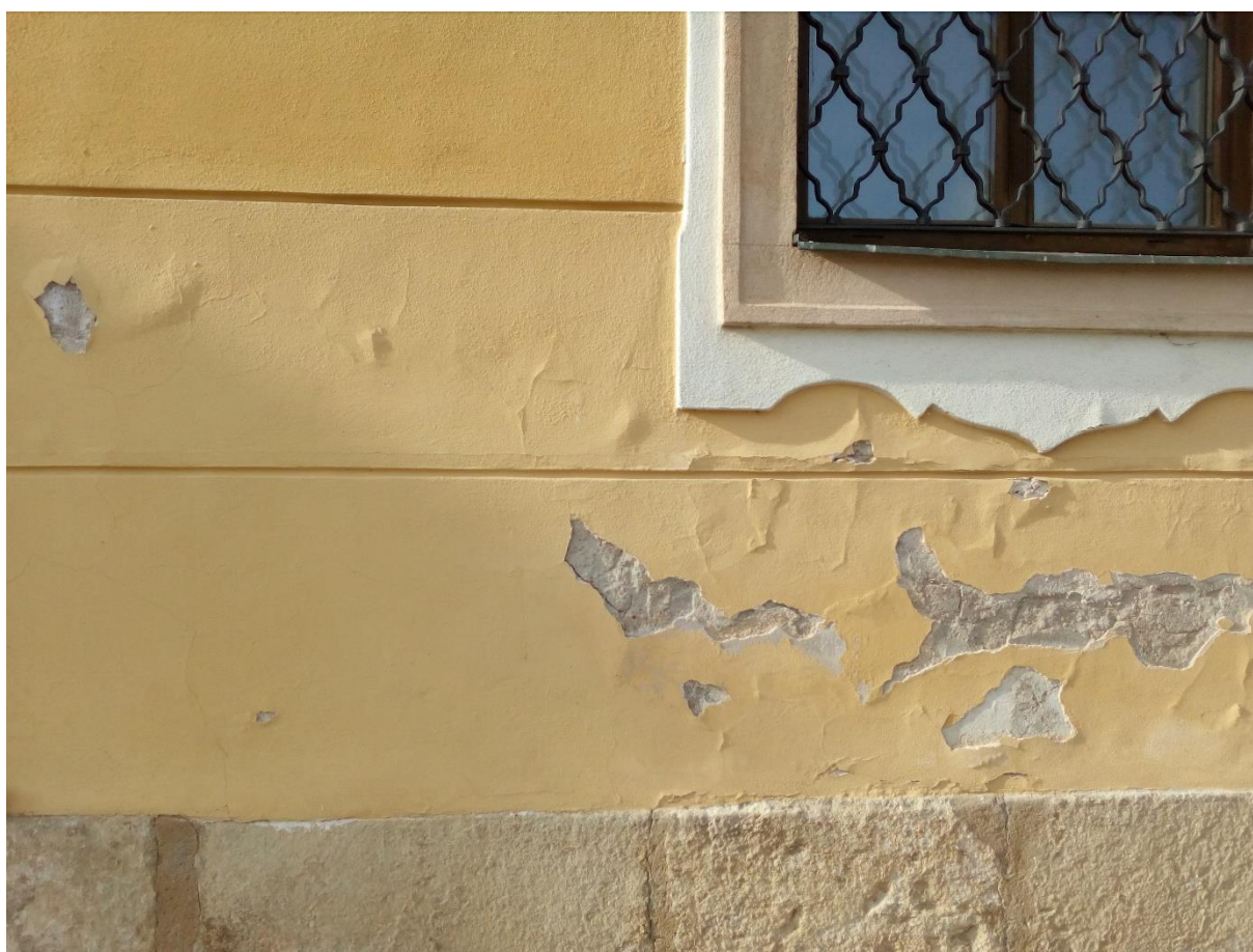
Obr. 25: Příklad fasády poškozené
