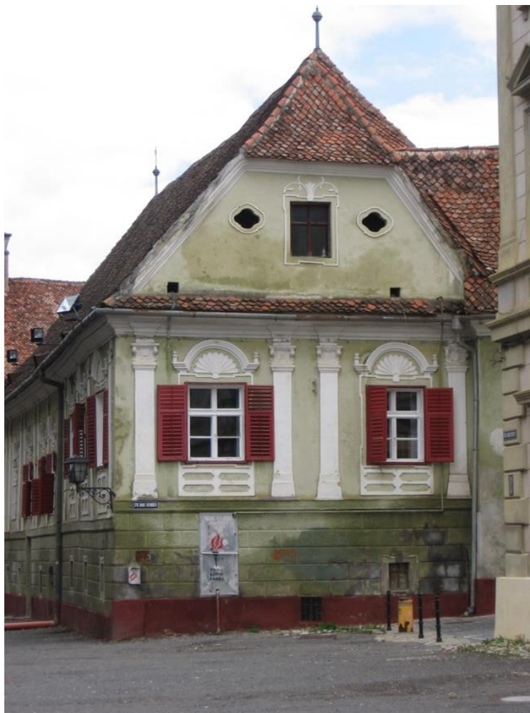
Obr. 26: Historická omítka ve městě Brašov poškozená vysokou vlhkostí
