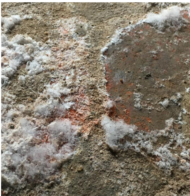
Obr. 19 Solné výkvěty (tzv. efflorescence) na povrchu degradované omítky (Klášter Plasy, foto K. Kroftová)
