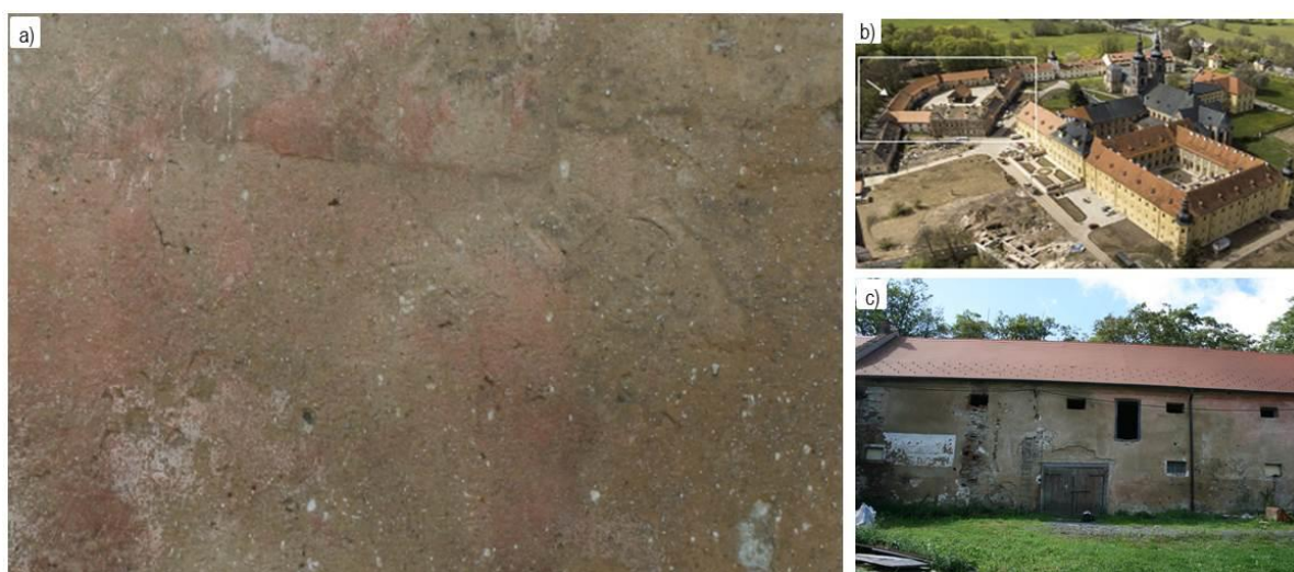
Obr. 91 Klášter premonstrátů v Teplé: a) detail degradované omítky na hospodářském objektu; b) letecký pohled na areál kláštera ( http://www.strukturalni-fondy.cz ); c) Hospodářský objekt, na kterém byla provedena aplikace nanotextilií in-situ
