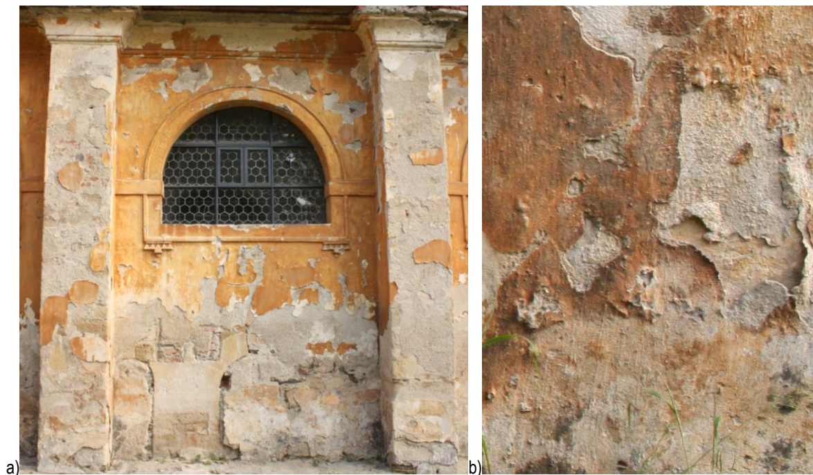
Obr. 22 Příklad degradace omítkového líce a následný rozpad přívěrchových vrstev způsobený synergickým negativním působením degradačních faktorů: a) pohled na výsek obvodového zdiva; b) detail degradovaného povrchu s patrným rozvrstvováním a rozpadem povrchových vrstev, barevnými změnami a mikrobiologickým napadením (kostel Nanebevzetí Panny Marie, Plasy, foto K. Kroftová)
