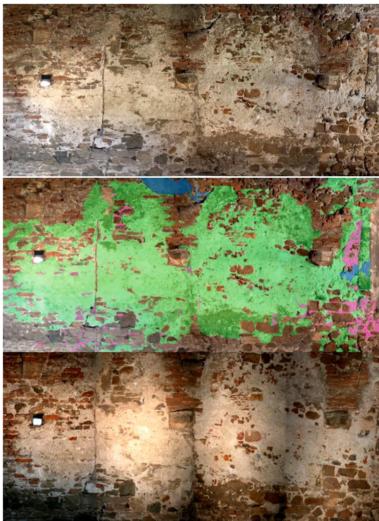
Obr. 32 Dokumentace konsolidované zdi ve 2. NP ambitu v klášteře Rosa Coeli v Dolních kounicích: a) stav před restaurováním; b) znázornění rozsahu dochovaných omítek podle jejich stáří: červená – nejstarší dochovaná vrstva, 12. století, modrá – pravděpodobně gotická omítka, 14. století, zelená – barokní omítka, pravděpodobně 18. století; c) stav po restaurování. (Machačko, L. et al, 2012)
