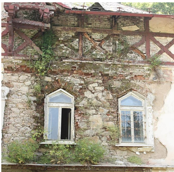
Obr. 21 Příklad rozsáhle degradace zdiva, vč. degradace a ztráty omítkových souvrství, způsobená intenzivním smáčením povrchu, zatékáním do konstrukce a rozvojem nižších i vyšších forem rostlin (Lázně Kyselka, foto K. Kroftová)
