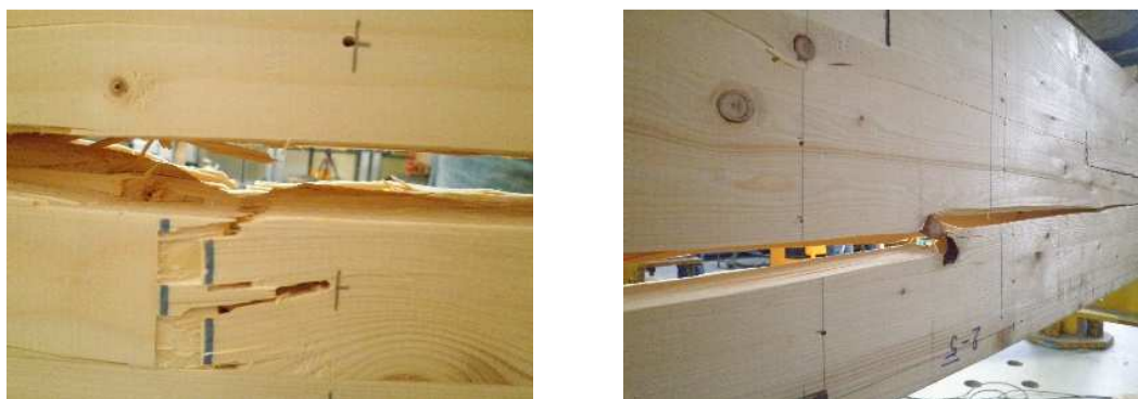
Obr. 4.3.1: Ilustrace detailů obou typů poškození.
