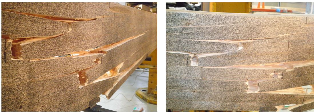
Obr. 3.5.1.7: Detaily poškození druhého nosníku třetí série v místě seskupení zubovitých spojů.
