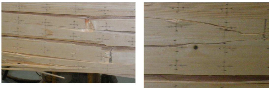
Obr. 3.4.2.5: Detail poškození v oblasti spoje a velkého suku spolu s ukončením šíření trhliny ve spoji.
