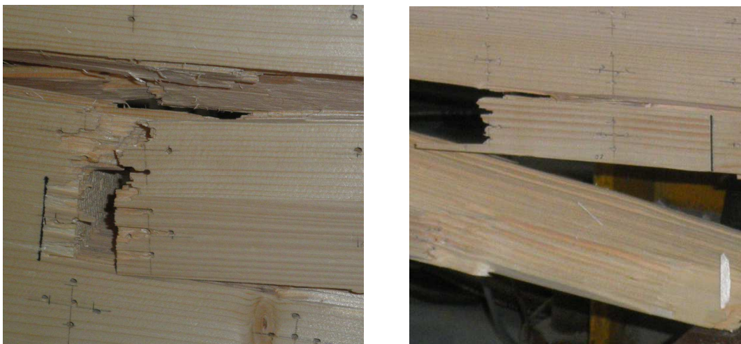
Obr. 3.4.2.8: Místo prvního poškození v zubovitém spoji spodní lamely a detail poškozeného spoje v jedné lamelě a dřeva ve stejném místě následující lamely.
