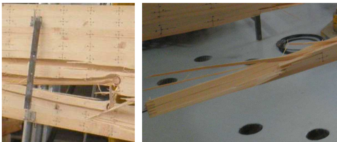
Obr. 3.4.2.2: Detail okolí suku, kde vznikla první trhlina a malého poškození zubovitého spoje, který ukončil šíření trhliny ve spodní lamelé.
