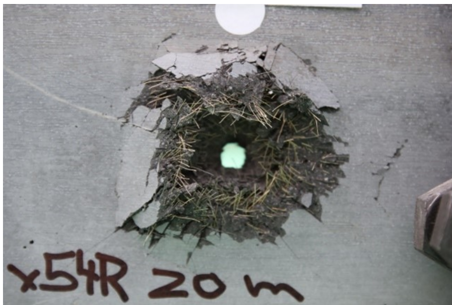
Obrázek 4.7: Kompletní perforace tenké UHPC desky s výrazně omezeným lokálním poškozením bez tvorby radiálních trhlin.
