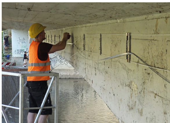
Detail instalace systému snímačů FBG pro sledování změn křivosti mostu.
